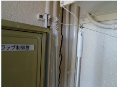
壁の亀裂(福島松川㊤)
