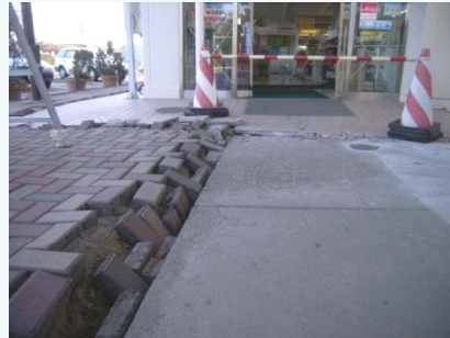
園地歩道部の段差(鏡石㊦)
