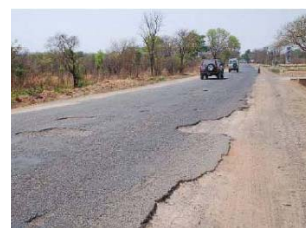
サブサハラ地域の道路損傷状況
