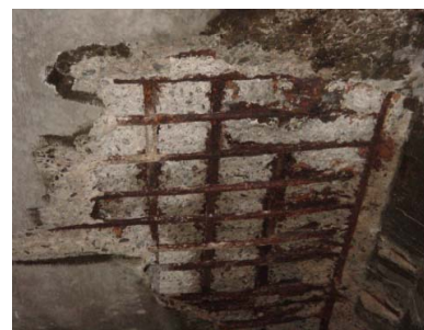
《床版下面損傷》
