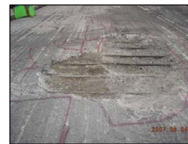
《床版上面損傷》
