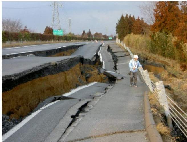
【道路の被災(常磐自動車道)】
