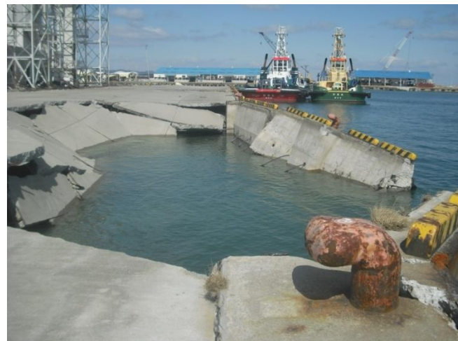
【岸壁の倒壊(相馬港)】
