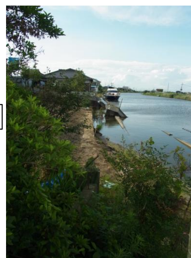
写② 堤防の崩壊
