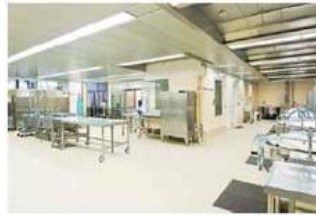
1000食規模の給食厨房 (「涼しい厨房機器」採用)
