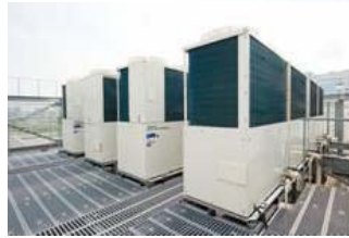
ガスヒートポンプ室外機 (発電機能付き)
