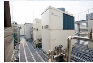
小型ガスエンジンコージェネレーション(停電対応機)
