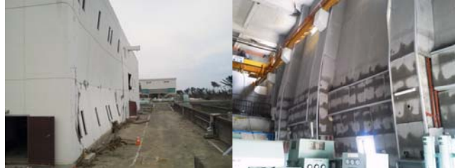
波力による被害
