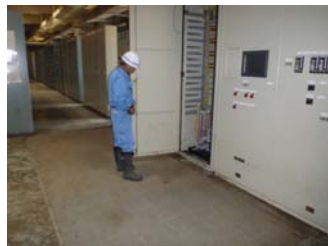
浸水による被害
