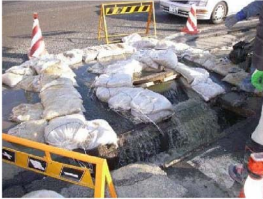
土のうを用いて近傍の側溝への消毒放流状況その1（多賀城市）
