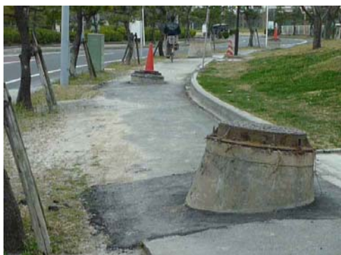
写真-6 浦安市のマンホール突出
