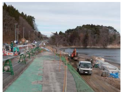
国道45号の車両通行可能な応急復旧は3月17日に完了。宮古市藤の川では、歩道の復旧工事を進めている。
