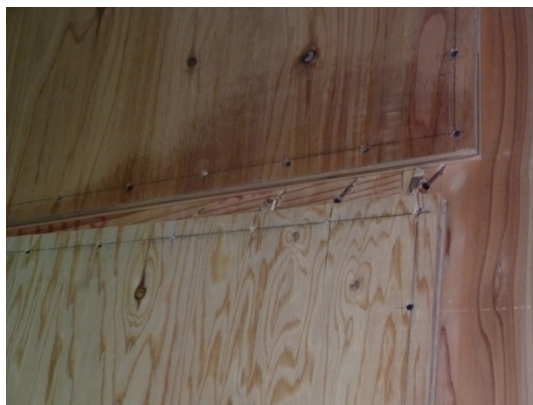
写真2 釘接合部の破壊 (パンチング)
