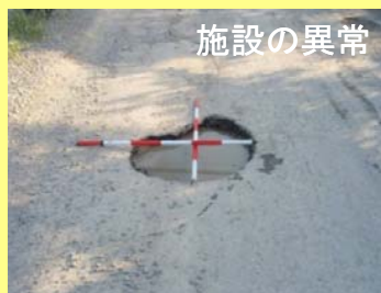
河川管理用道路に生じた陥没
