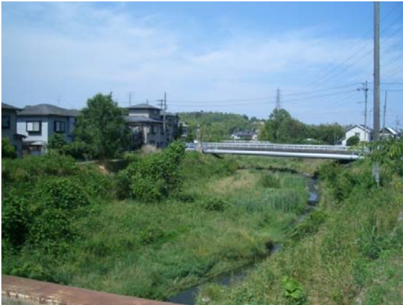
草丈が長いと堤防の変状が分からない
