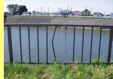
防護柵の損傷
