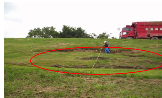
ひび割れ発見
