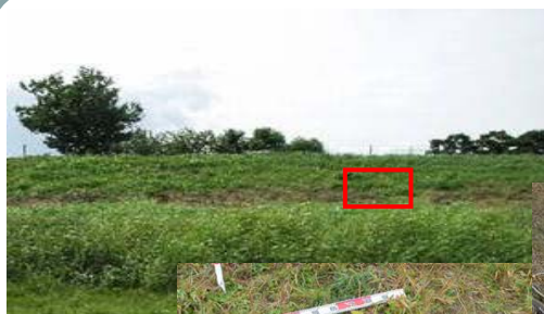
陥没の発見・調査
