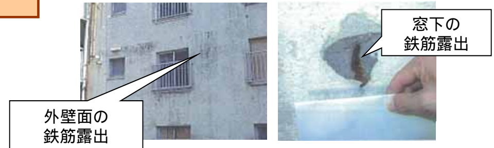
経年によりコンクリートが剥離し、外壁面の鉄筋が露出している事例
