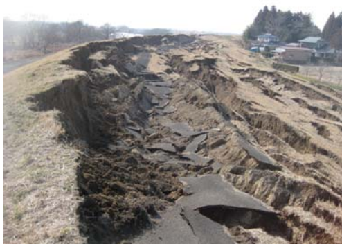
鳴瀬川左岸 30.3k 付近 (大崎市古川下中ノ目地先) ※地震により縦断クラック発生
