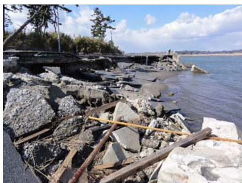
鳴瀬川右岸 0.0k 付近 (東松島市野蒜地先) ※津波により堤防が流出
