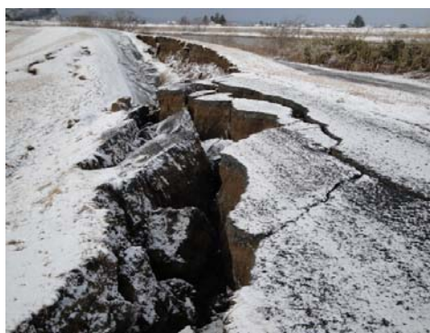
鳴瀬川左岸 11.4k 付近 (美里町二郷地先) ※地震により縦断クラック発生
