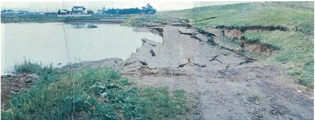
▲千代大橋橋脚上部のコンクリート剥離と鉄筋座掘(上左) 堤防天端縦断亀裂と特殊堤の傾斜 名取市関上(上右) 堤防裏法面のすべりによる亀裂 名取川右岸・名取市鍋沼(下) 【出典：1978 年宮城県沖地震被害報告書 土木学会】
