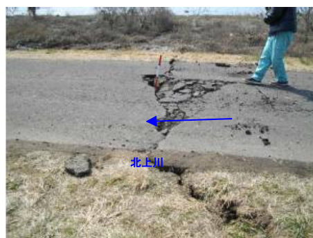
名取川左岸 2.9k 付近 (仙台市若林区今泉地先) ※地震により横断クラック発生
