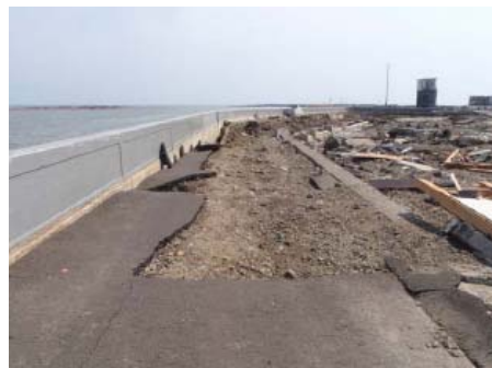
名取川右岸 0.2k 付近 (名取市閑上地先) ※津波により堤内地侵食
