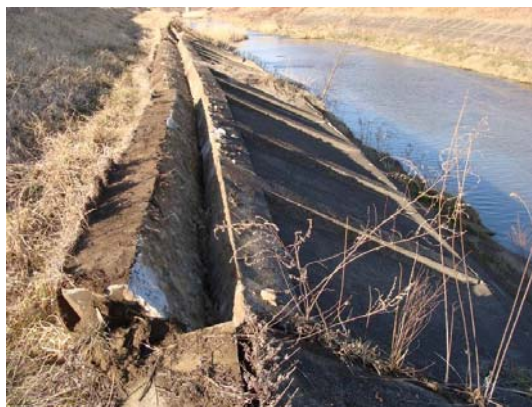
阿武隈川右岸 61.0k 付近 (東根川地先) ※地震による護岸破壊
