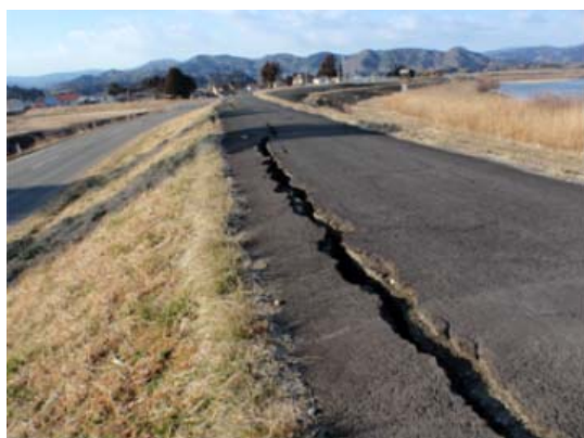
阿武隈川右岸 33.0k 付近 (丸森町小齊地先) ※地震による堤防亀裂
