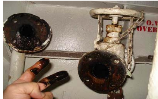
油水分離器作動不良による排水管汚損
