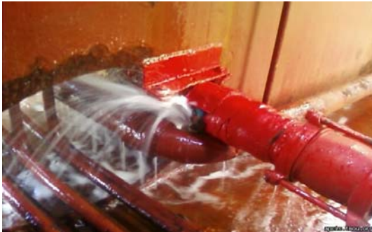
消火主管の腐食割れ
