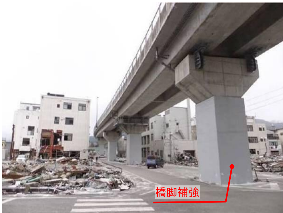
国道45号（観測震度：震度6弱）
