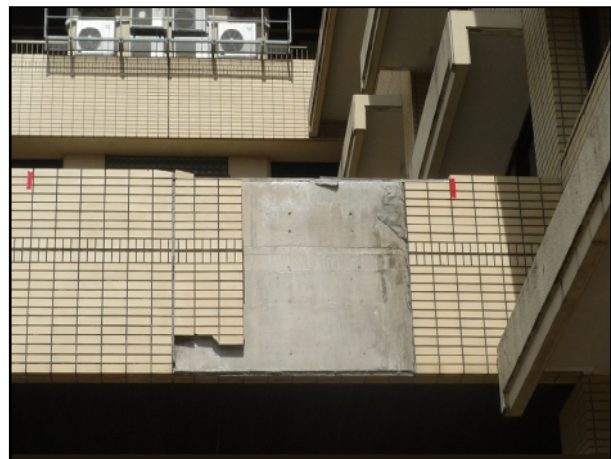
〈落下した外壁タイル〉
