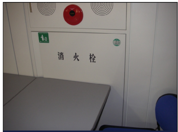
〈使えない屋内消火栓〉
