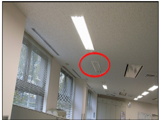
〈停電時に点灯しない照明〉
