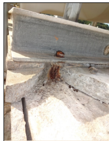
〈屋上基礎の劣化〉
