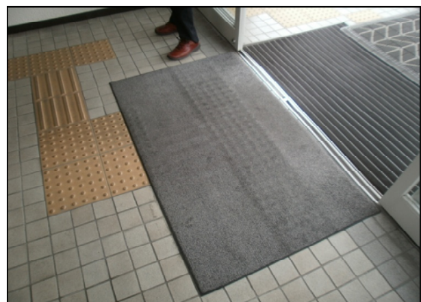
〈認識できない誘導用ブロック〉
