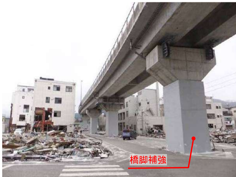
国道45号（観測震度：震度6弱）
