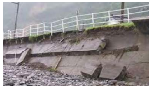
平成19年新潟県中越沖地震における護岸の被災(上輪海岸)
