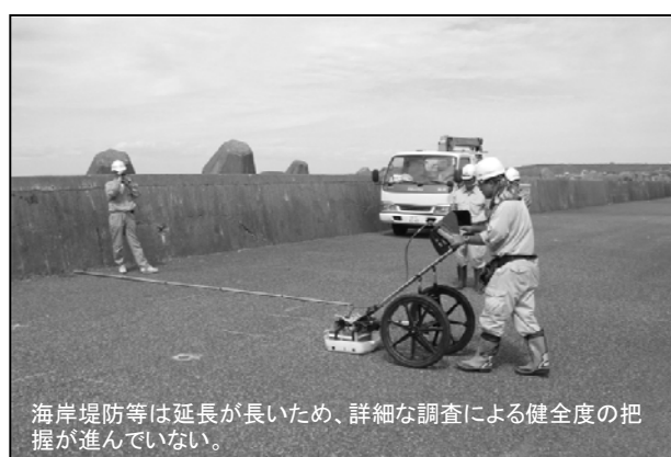
【長寿命化計画策定に必要な空洞化調査例】
