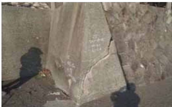
コンクリート擁壁工のひび割れ
