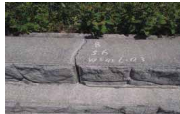
波返し工のひび割れ
