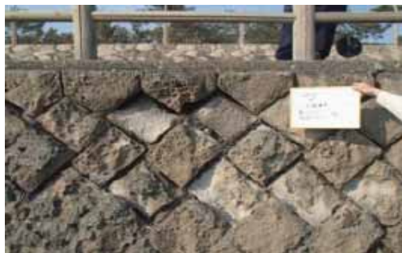
ブロック積みのはらみ、目地材の流出
