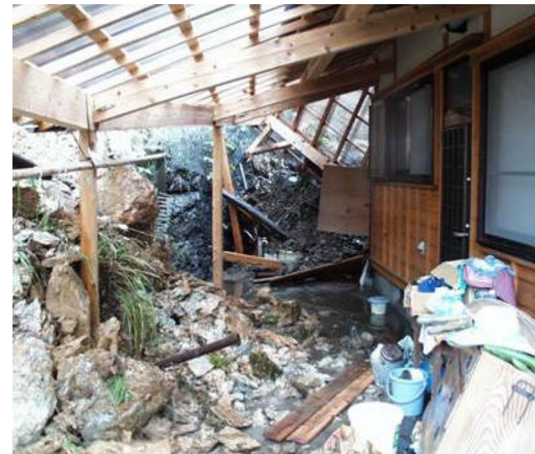
高知県土佐町東石原崩壊箇所 (一部損壊1戸)
