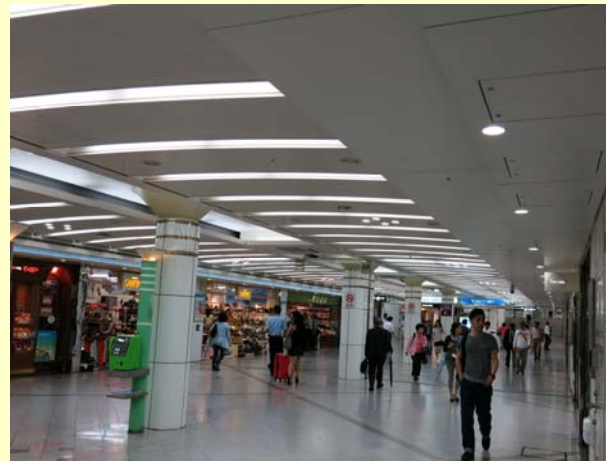
金属パネル天井
