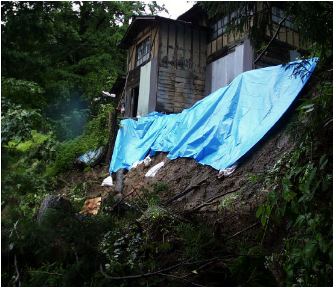
人家直下の斜面で地すべりが発生し、崩壊土砂が県道新井飯山線に流出し全面通行止となった。
