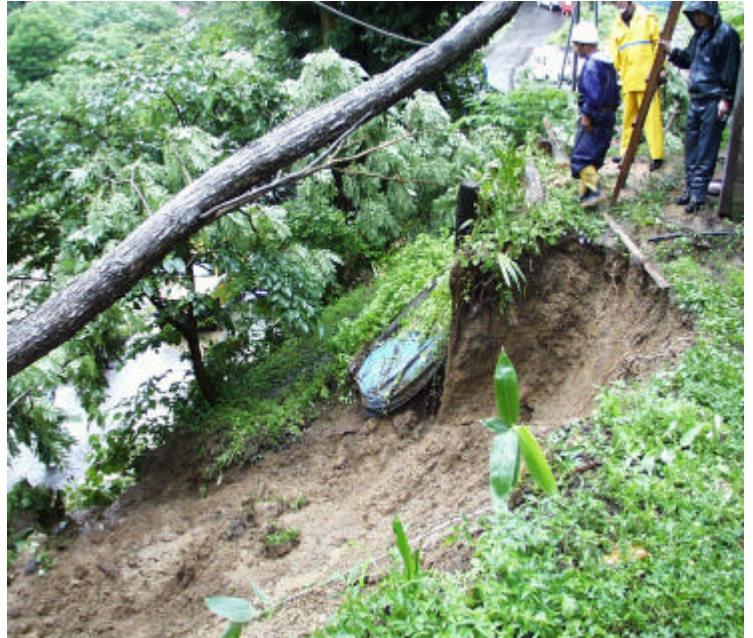
地すべり源頭部の状況
