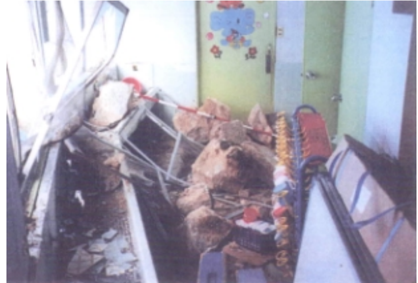
幼稚園に落石が・・・ (平成13年3月芸予地震: 広島県呉市)
