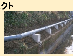
実証技術の事例 (露出配管)
