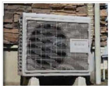
空気熱源ヒートポンプ
