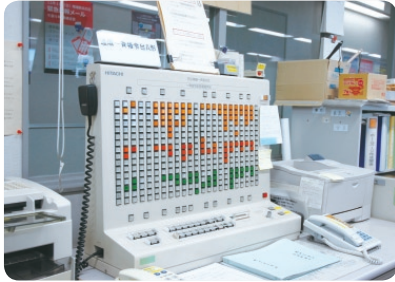
防災行政無線一斉指令台。市町の受信確認はボタンの点滅で分かるようになっている。
