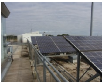
■空港事務所屋上の太陽光発電
