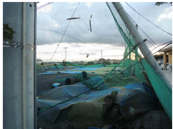
写真 4. 4. 6 テニスコート人工芝等の被害
