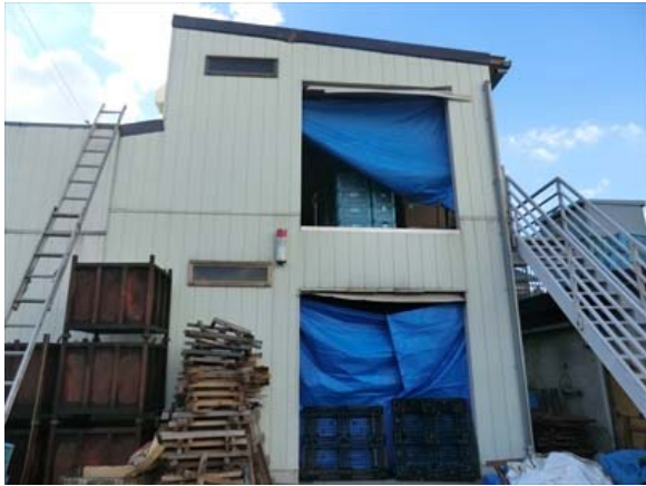
写真 5. 1. 7 シャッターの被害
