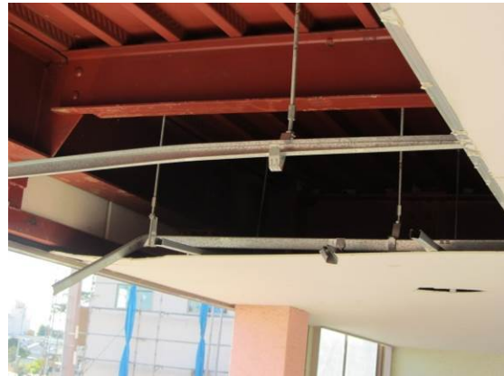
写真 4. 1. 22 天井の下地材の変形
