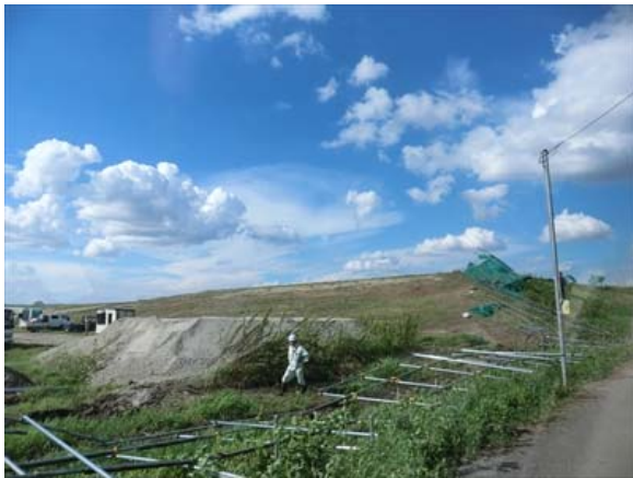
写真 5.2.20 フェンスの被害
