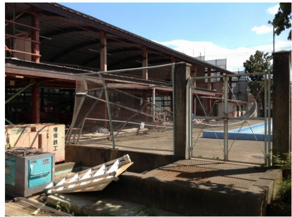
写真 5.2.19 フェンスの被害（工事中の建築物）
