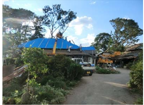
写真 5.1.2 屋根ふき材の被害
