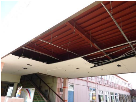
写真 4. 1. 21 ピロティの天井の被害
