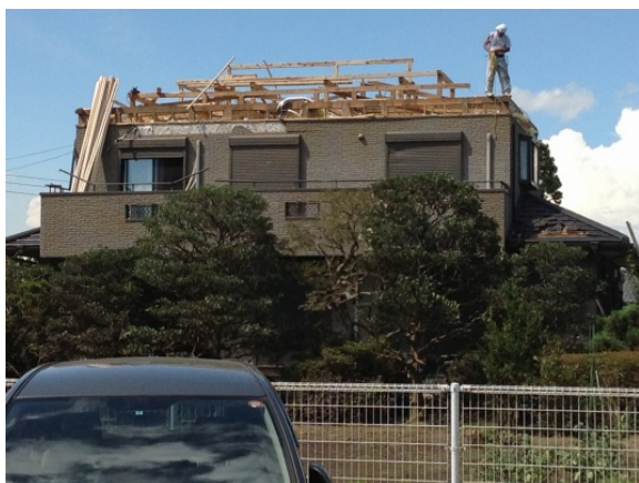
写真 5. 2. 5 小屋組の被害
