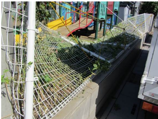
写真 4. 1. 14 フェンスの倒壊
