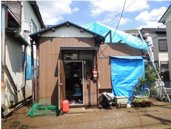
写真 4.2.7 小屋組の被害
