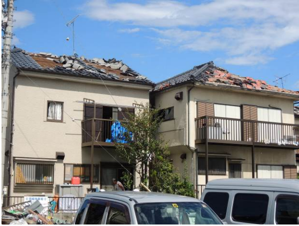
写真 4.2.9 粘土瓦の脱落状況
