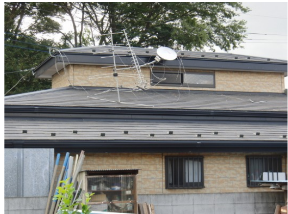
写真 5.2.21 アンテナの被害
