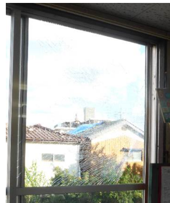
写真 4. 1. 20 合わせガラスの放射状のひび割れ
