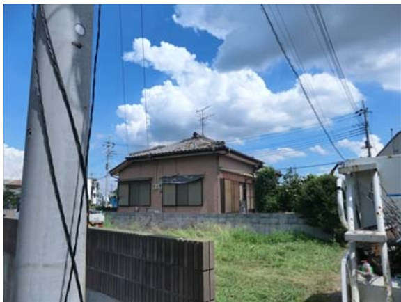
写真 5. 2. 1 屋根ふき材の被害
