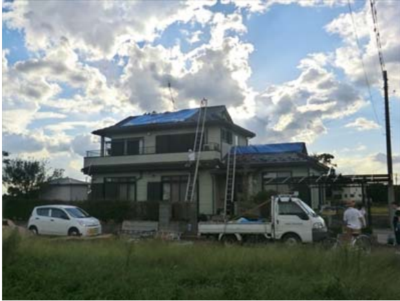
写真 5.1.1 屋根ふき材の被害
