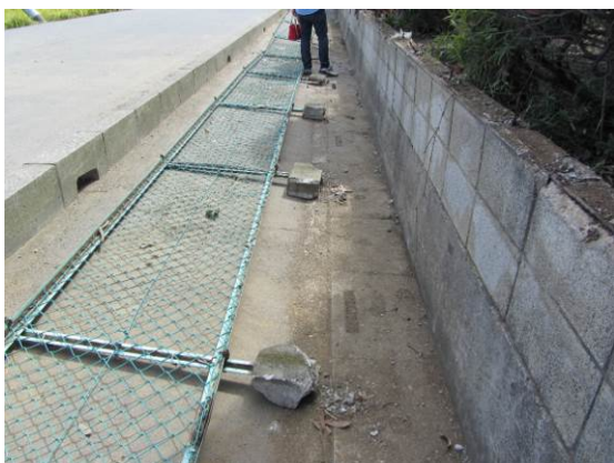
写真 4. 1. 9 フェンスの倒壊
