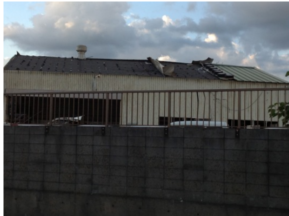
写真 5.1.5 屋根ふき材の被害
