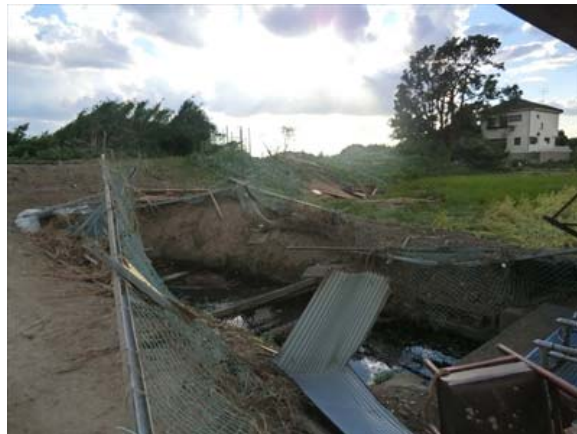
写真 5. 1. 16 フェンスの被害
