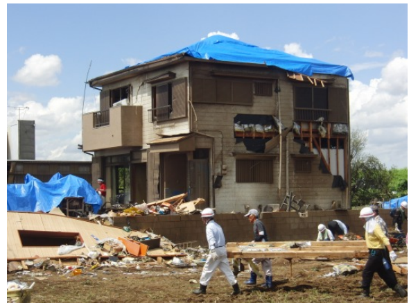
写真 5.2.11 外装材の破損
