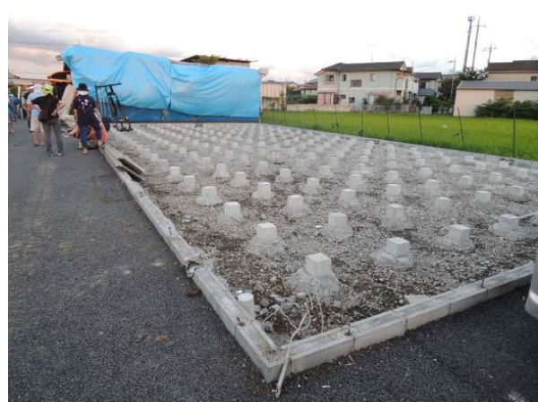
写真 4.2.4 飛散した上部構造の基礎
