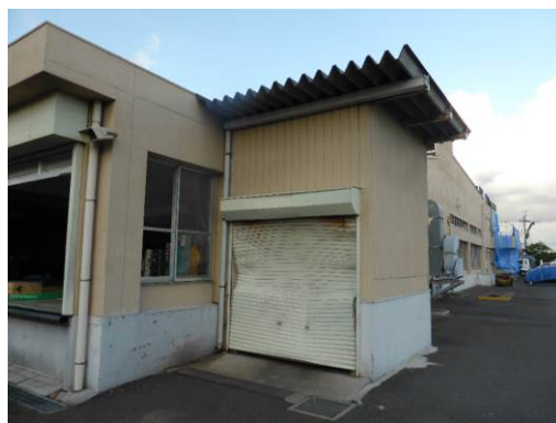
写真 4. 1. 30 シャッターの変形
