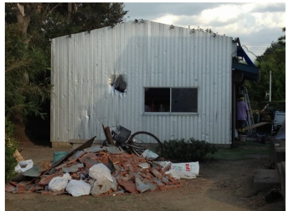
写真 5. 1. 10 外装材の被害
