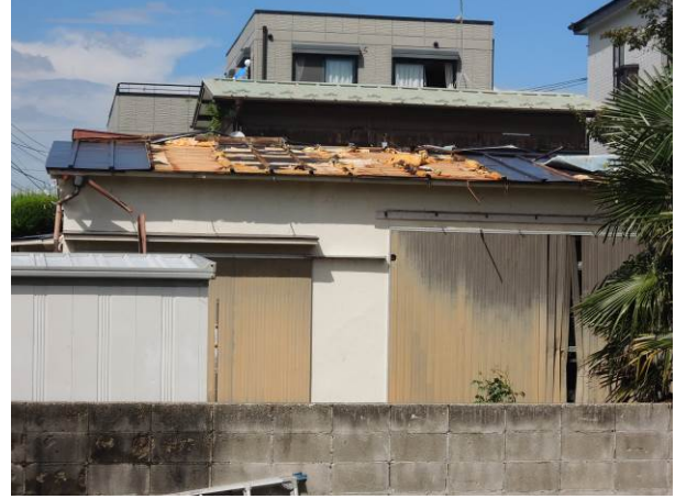
写真 4.2.10 屋根鋼板の飛散状況
