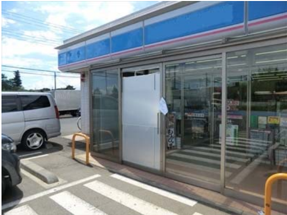
写真 5.2.8 ガラスの破損
