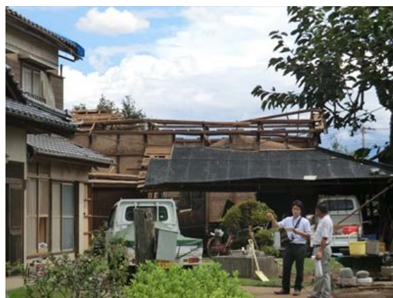
写真 5. 2. 4 小屋組の被害
