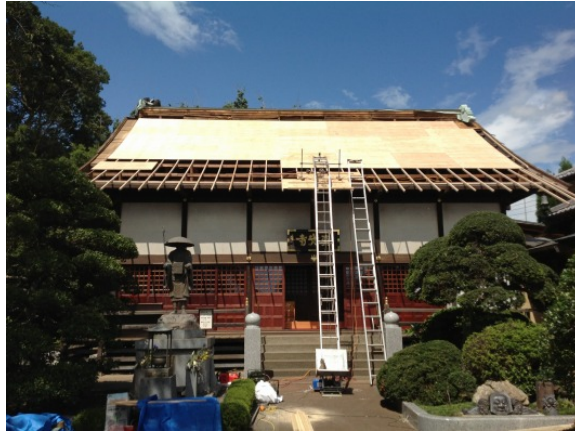
写真 5.2.7 屋根ふき材の被害（社寺建築）
