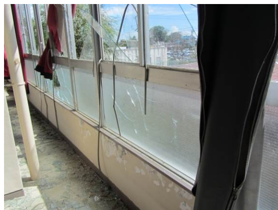
写真 4.1.8 ガラス窓の破損
