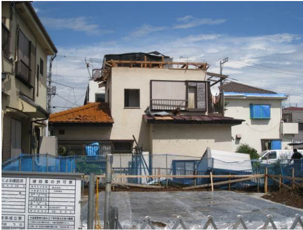
写真 4.2.5 小屋組の被害
