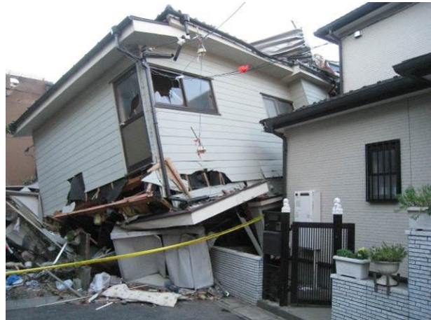
写真 4.2.2 上部構造の倒壊 (2)
