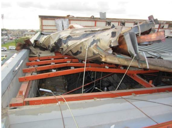
写真 4. 1. 25 鋼板製の屋根ふき材及び母屋の破壊
