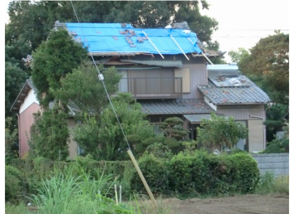
写真 5.1.6 屋根ふき材の被害
