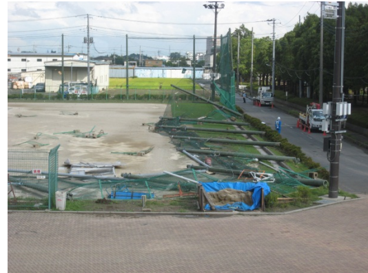
写真7 ネット支持柱の被害
