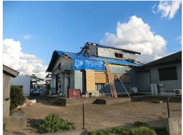
写真 5.1.4 屋根ふき材の被害
