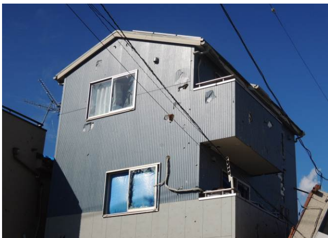
写真 4.3.1 外壁の飛来物による衝突痕
