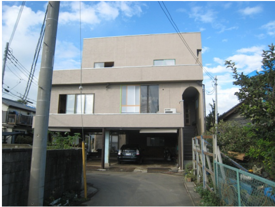
写真4 鉄骨造住家の被害
