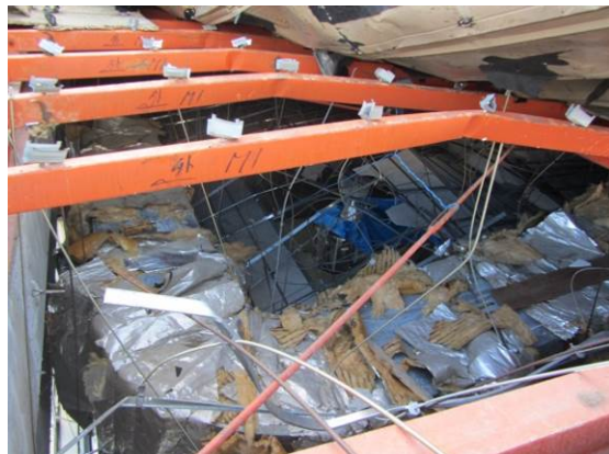
写真 4. 1. 26 母屋及び天井の破壊
