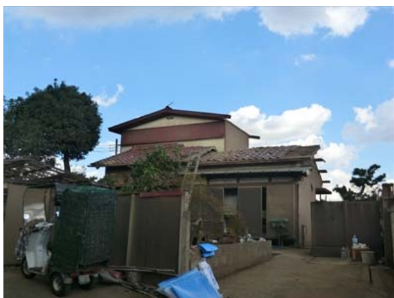
写真 5. 2. 3 小屋組の被害
