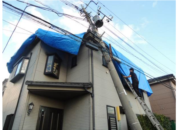
写真 4. 4. 4 電柱の折損 (隣家に衝突している)
