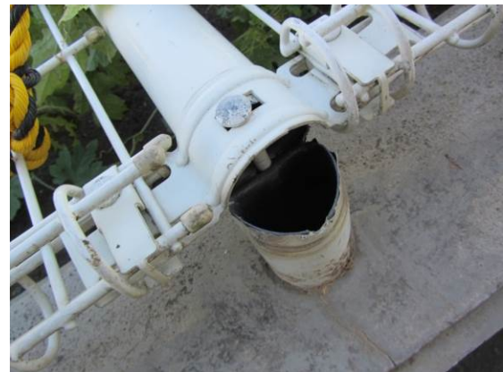
写真 4. 1. 15 支柱部の破断
