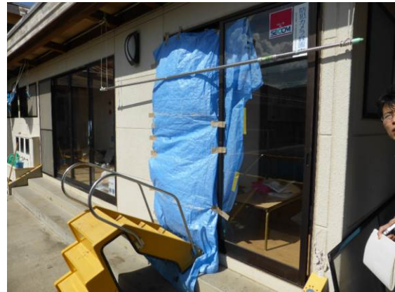
写真 4. 1. 13 飛来物により破損したガラス戸と外壁
