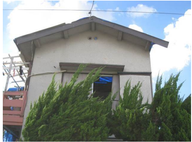
写真 4.2.6 屋根の軒先の被害
