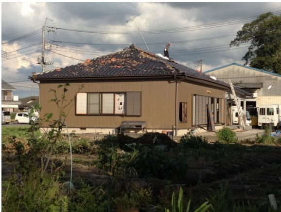
写真 5.1.3 屋根ふき材の被害
