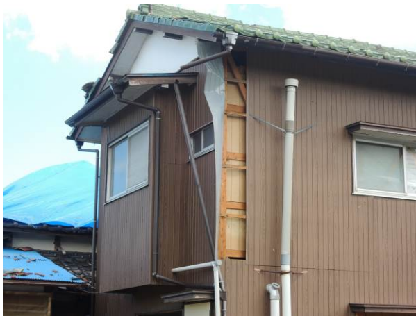
写真 4.2.11 外壁材の剥離
