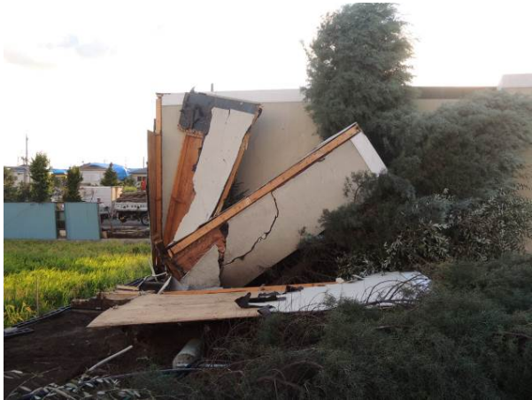
写真 4. 4. 5 木製塀の倒壊
