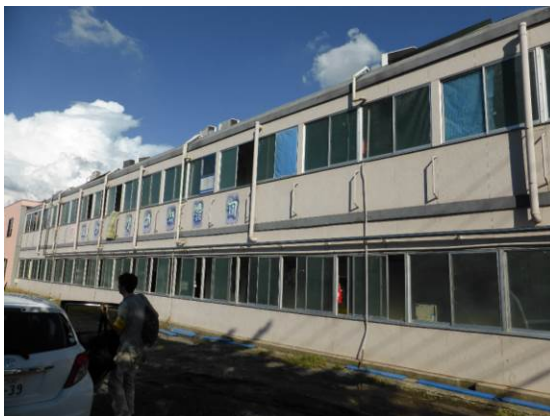
写真 4. 1. 19 建築物外観及び網入りガラス損傷
