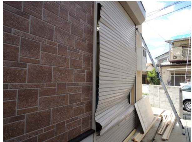
写真 4.2.12 シャッターの被害
