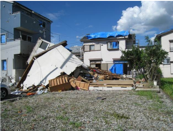
写真 4.2.1 上部構造の倒壊 (1)
