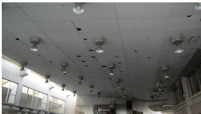
写真 4. 1. 29 天井の部分的な損傷
