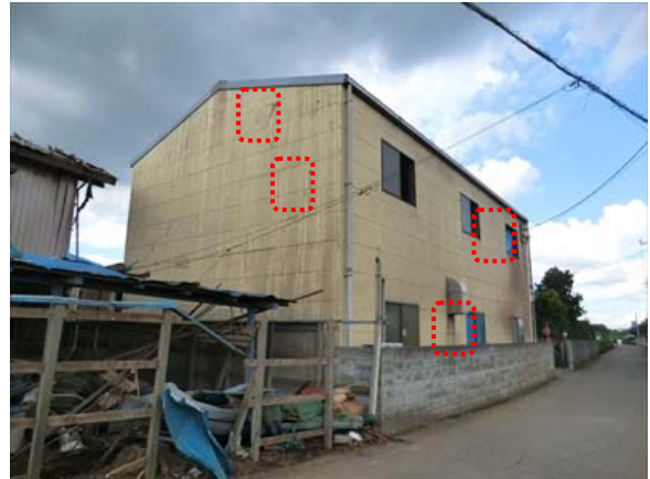
写真 5.2.9 外壁材及びガラスの破損
