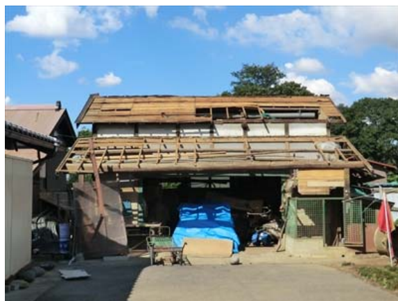
写真 5. 2. 6 小屋組の被害
