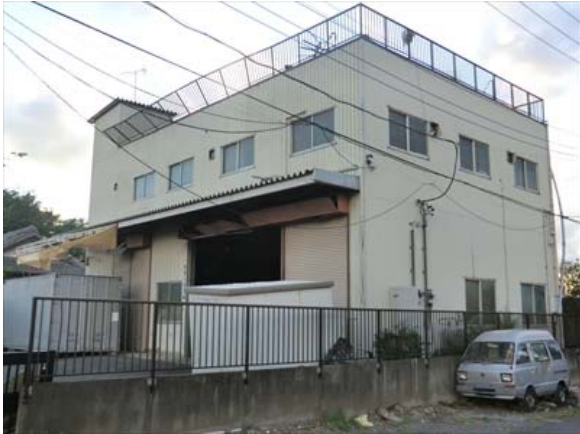
写真 5. 1. 14 屋上フェンスの被害
