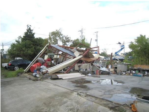
写真2 軽量鉄骨造住家兼作業場跡
