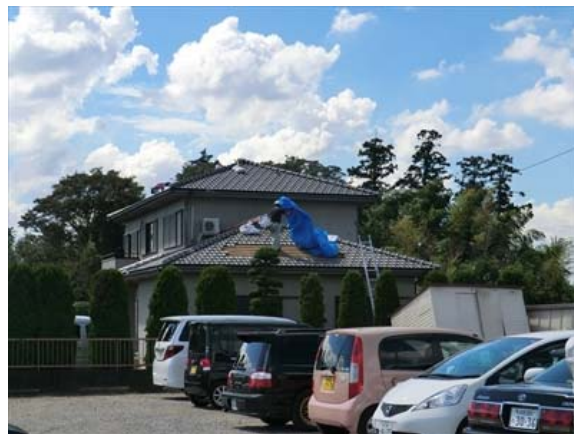
写真 5. 2. 2 屋根ふき材の被害
