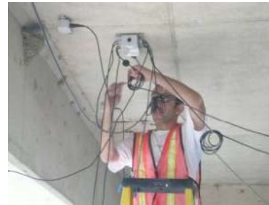
図-2: 橋梁の下部に取り付けられたB-WIMシステム
