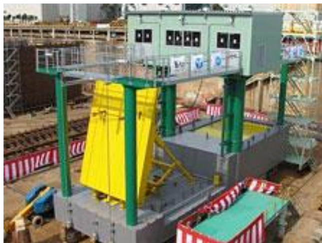
海底設置型フラップゲート
