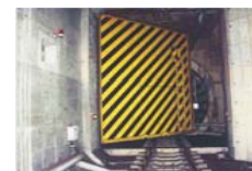
トンネル内防水ゲート
