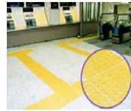
視覚障害者誘導用ブロック
