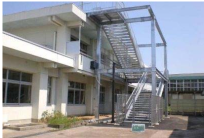
公共施設屋上利用のための 避難設備事例
