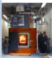
ペレットボイラー
