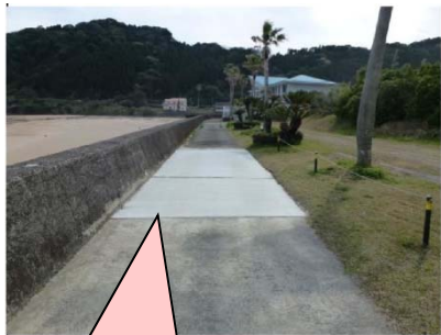
空洞をコンクリートで埋戻し補強し、上部付近は砂により締固め
