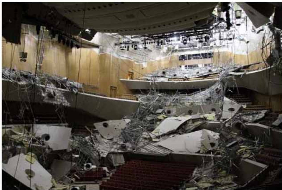
音楽ホールにおける天井の脱落
