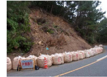
奄美大島豪雨による切土法面崩落 → 復旧に3日(H22.10 奄美市)
