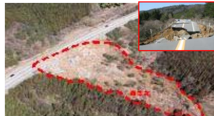
能登半島地震による 盛土法面崩落(H19.3) → 地下排水構造物未施工が原因 復旧に6ヶ月
