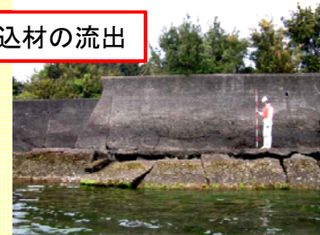
護岸下部の亀裂・崩壊
