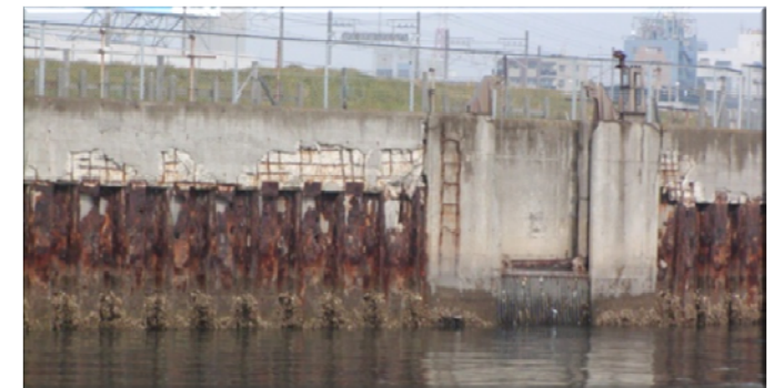
鋼矢板の腐食・コンクリートの劣化
