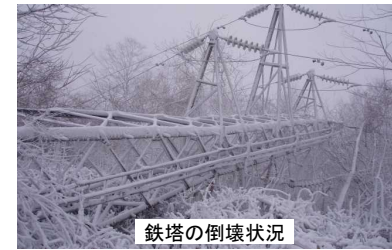
鉄塔の倒壊状況
