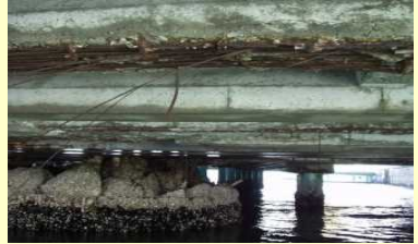
<劣化や変状が顕在化した施設の増加>
