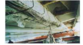
塩害によるコンクリート構造物の劣化事例
