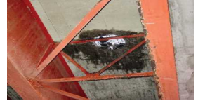
コンクリート床版の疲労事例
