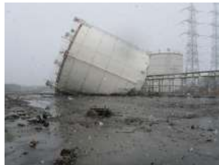
被災したガスホルダー(仙塩浄化センター)
