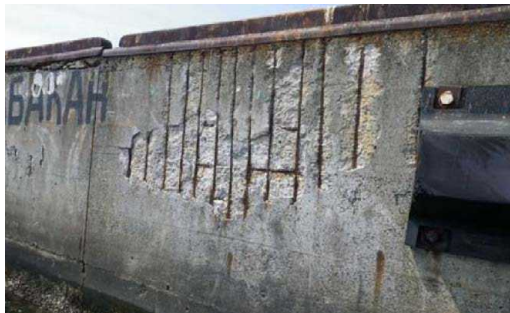
《金城ふ頭における岸壁の老朽化状況》
