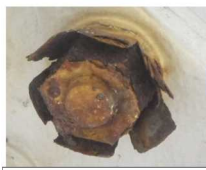
腐食高力ボルト
