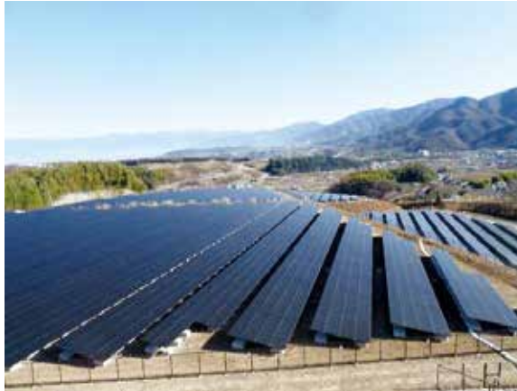
図表2-6-22 米倉山太陽光発電所
