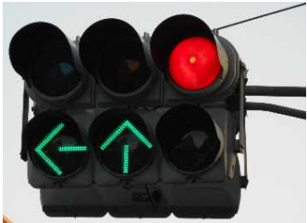
信号機の多現示化 信号灯器のLED化
