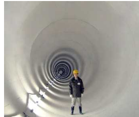
下水道の整備
