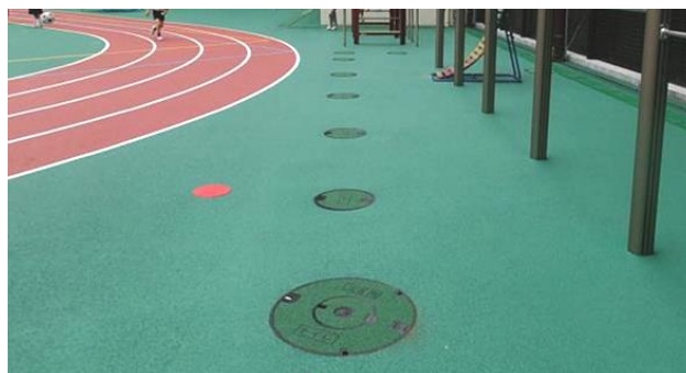
写真 3-1 学校に設置されたマンホールトイレ
