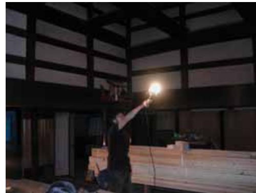
修復中の家屋。職人は富山市に立地する職人養成の専門学校「職藝学院」出身の20～30代の若者が中心。
